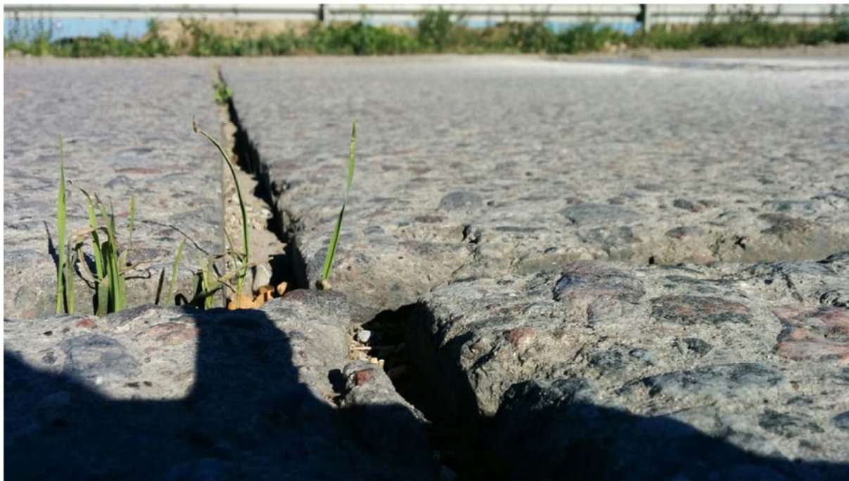
Foto 3. Betoonplaatide omavaheline nihe
