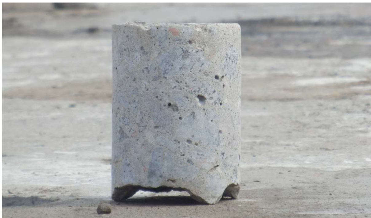
Foto 5. Betoonkattest võetud puurkeha
